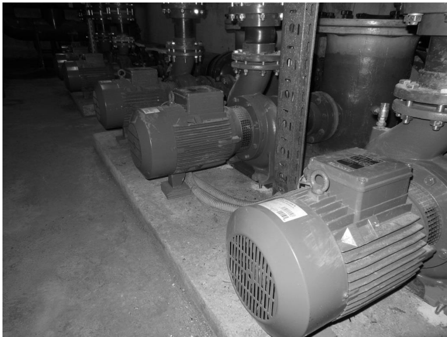
Slika 1: Nove učinkovitejše črpalke za cirkulacijo bazenske vode.
