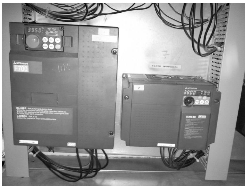
Slika 2: Frekvenčni pretvorniki vgrajeni znotraj hlajenih električnih razdelilnikov
